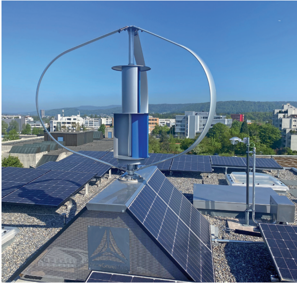
Unabhängig von Windrichtungen erzeugt ein hybrides Wind-Solar-Kleinkraftwerk bei tiefem Sonnenstand, bei Nacht, Schnee sowie Regen zusätzliche Energie.
